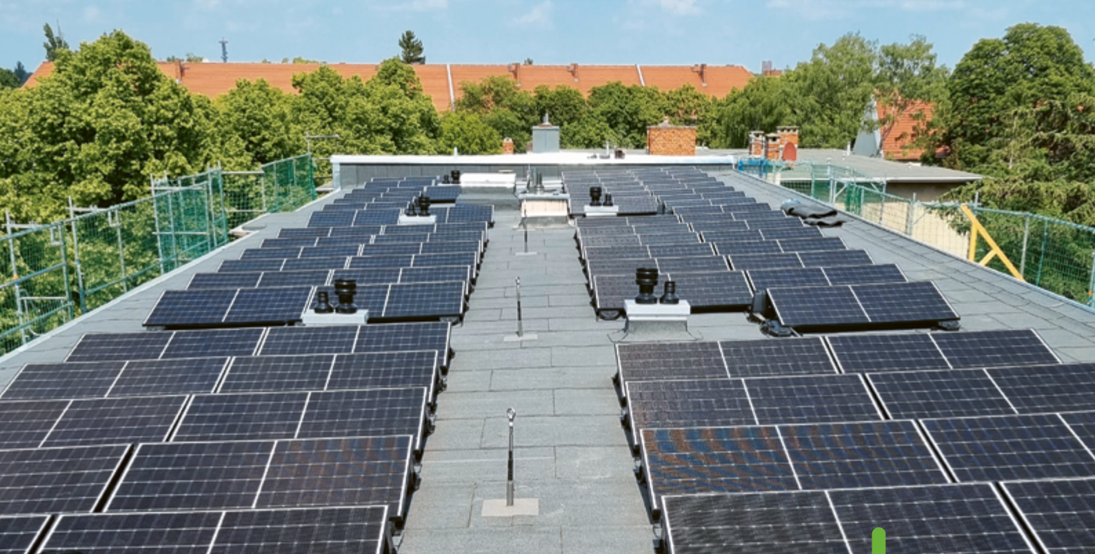
Die Sonne bei der Arbeit: PV-Anlagen in der Melanchthonstraße 8, 8A
